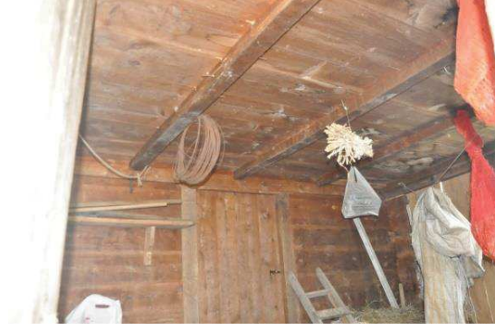
Resim 259:Sugören 30 Kapı Numaralı Tekir Balkon Tavanı
