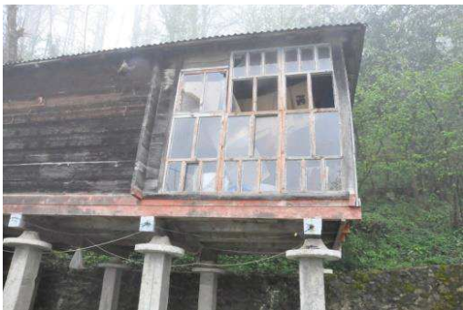
Resim 198: Sabri Tonk Tekiri Sonradan Kapatılmış Balkon Bölümünün Pencerelemi
