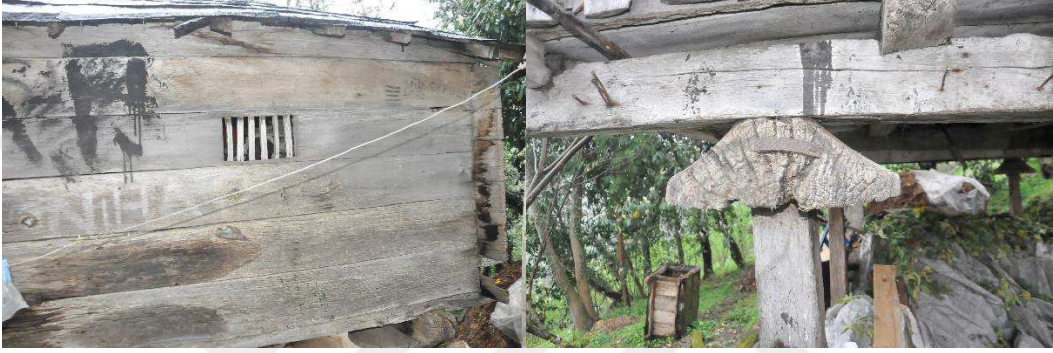
Resim 123: Esmayılmaz Tekiri Güney Cephesindeki Pencere Açıklığı ve Ahşap Ayak ile Aşağı
